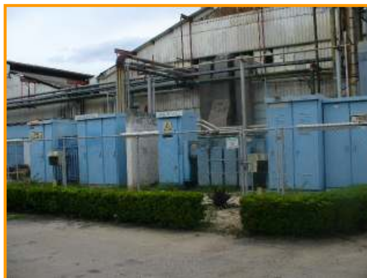
SUBESTACIONES DE TRANSFORMACION 2400/480 VAC S/E Casa fuerza (1+2)= 2675 KVA (dentro Casa de Fuerza), Uno de Piranol S/E Acetato (1+2+3)= 3350 KVA (Fuera de Casa de Fuerza), Uno de Piranol
