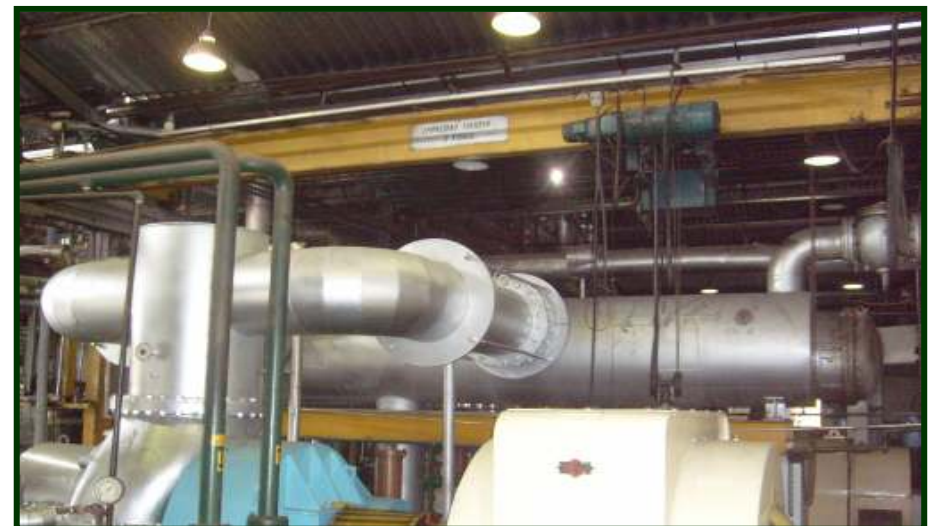
CONDENSADOR DE LA TURBINA 4. Cap: 8.300.000 Kcal @ 34840 LB/HR DE Vapor.
