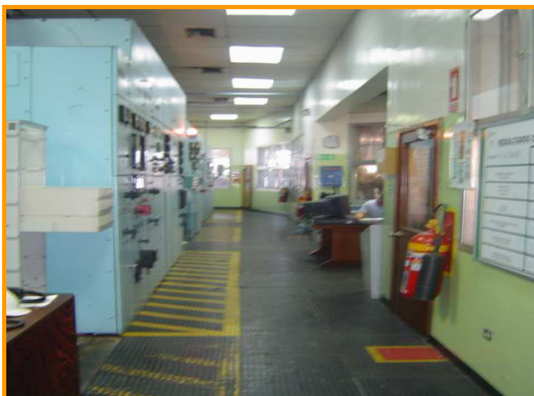
PANEL DE DISTRIBUCION Y CONTROL DE GENERACION DE ELECTRICIDAD, Cap barra: 12 MW@2400 VAC, Generación: 6.4 MW, 2 turbinas a Condensación (5,25 MW) y 1 de Contrapresion (1,2 MW)
