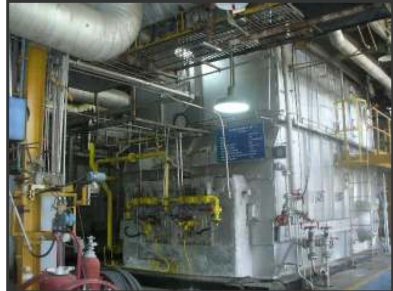
CALDERA 1, Cap: 10 tn/hr @ 600 psi @ 750 °F, Vapor Sobrecalentado
