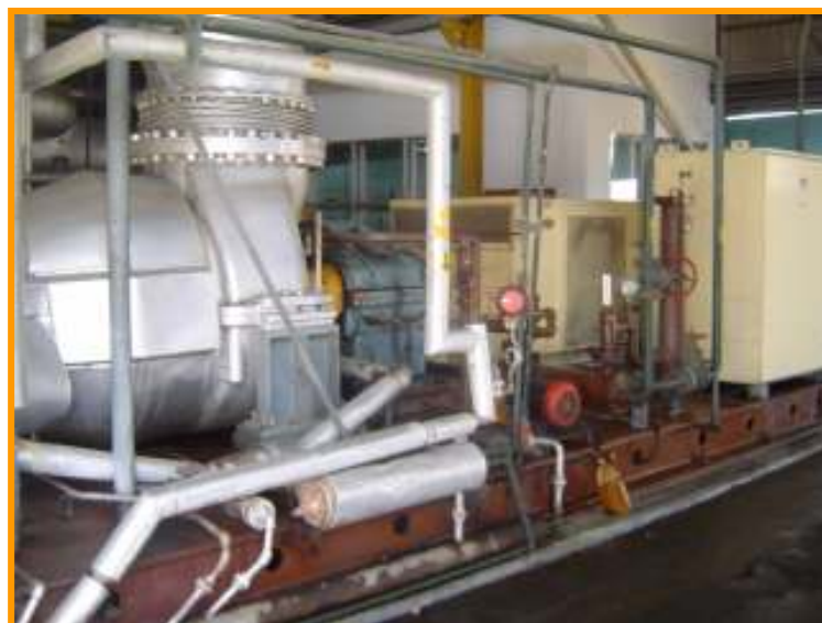
TURBO-GENERADOR N°5, Cap: 2,75 MWhr @ 2400 VAC
