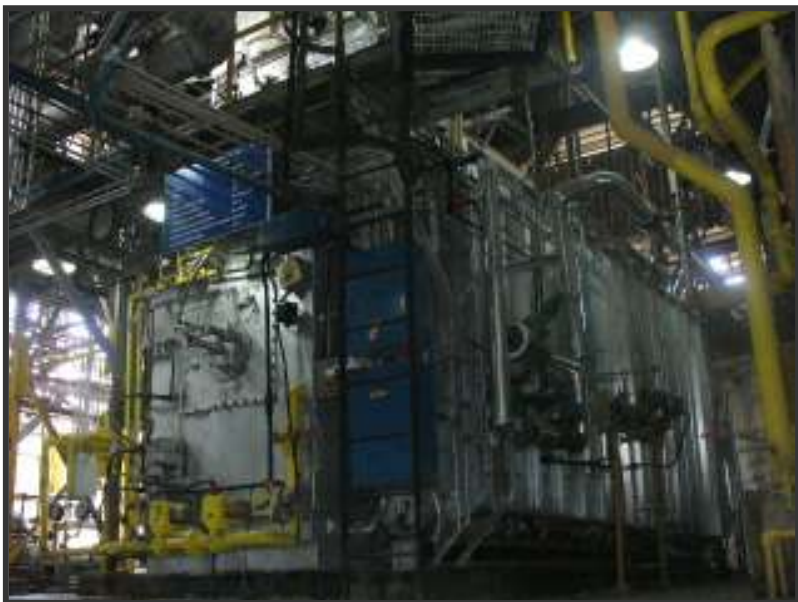
CALDERA 3, Cap: 18 tn/hr @ 600 psi @ 750 °F, Vapor Sobrecalentado
