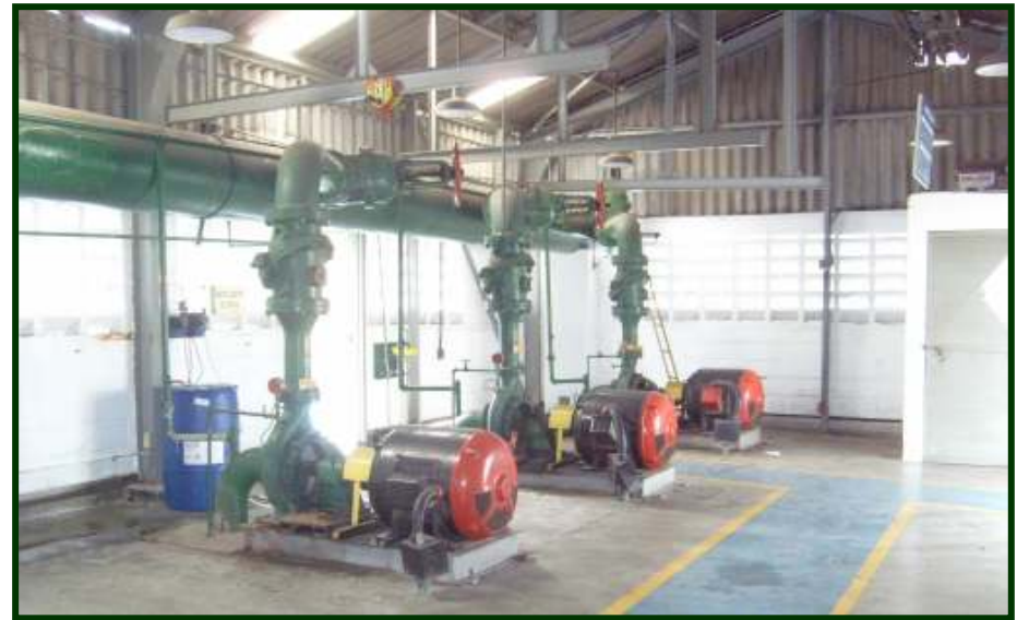
BOMBAS DE CIRCULACION AGUA TORRE ENFRIAMIENTO, COMPUESTA POR 4 BOMBAS, Cap: 2100 GPM @ 70 psi, Cada Bomba.
