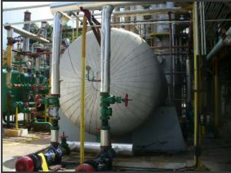
TANQUE DE SERVICIO, Cap: 20m3
