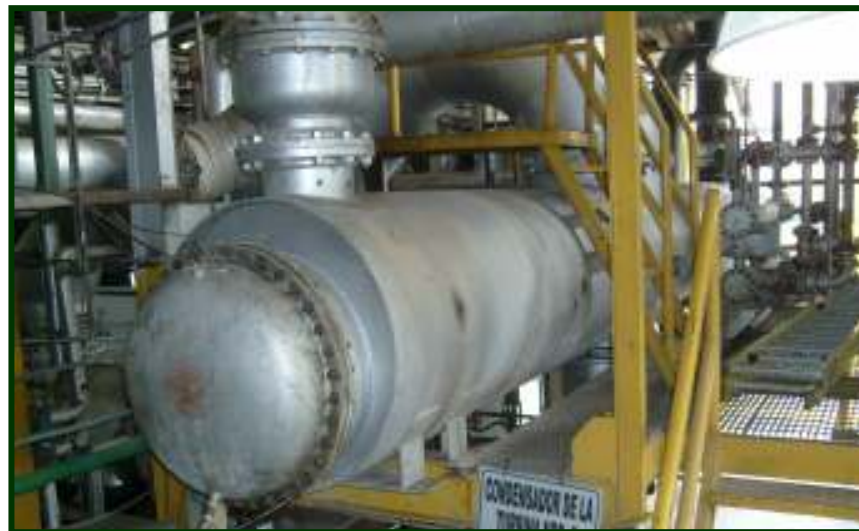
CONDENSADOR DE LA TURBINA 5. Cap: 8.150.000 Kcal @ 30636 LB/HR DE Vapor.
