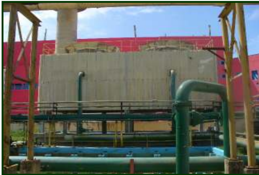
TORRE DE ENFRIAMIENTO, COMPUESTA POR 2 CELDAS Cap: 5.700.000 Kcal, \Delta T : 10°C @ 3000 GPM (Cada celda).
