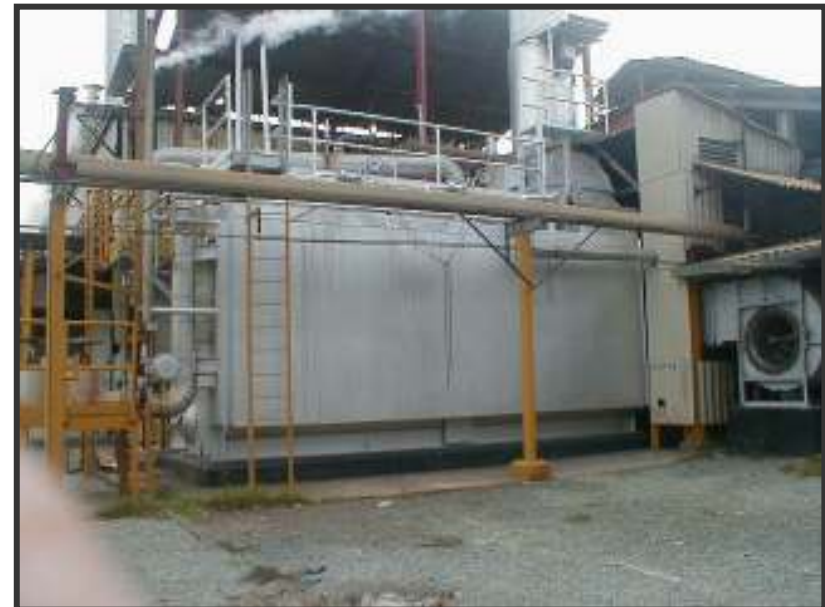
CALDERA 4, Cap: 36 tn/hr @ 600 psi @ 750 °F, Vapor Sobrecalentado
