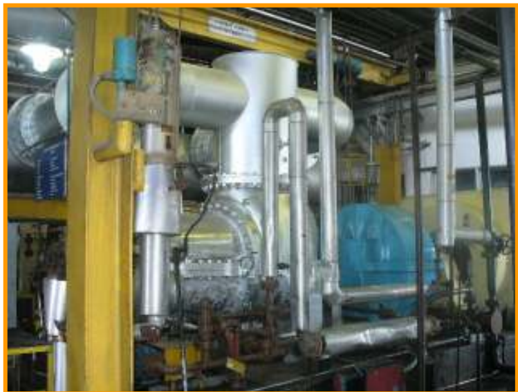
TURBO-GENERADOR N°4, Cap: 2,5 MWhr @ 2400 VAC
